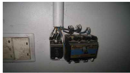
5. 차단기 노출 설치
