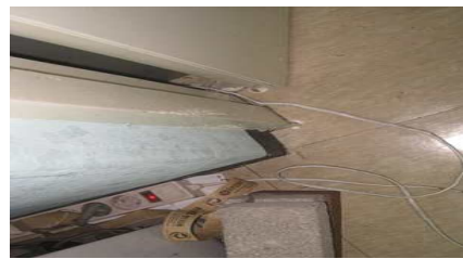
3. 바닥 배선정리 미흡 (문틈에 끼어 단락 우려)
