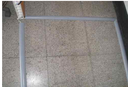
몰딩 등을 이용한 배선 정리(예)
