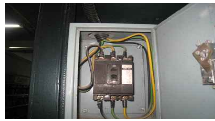
9. 전기기계기구 접지선 미연결 (배기팬)
