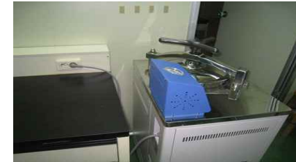
1. 고용량기기 단독회로 미구성 (고압멸균기-3.0kw)
