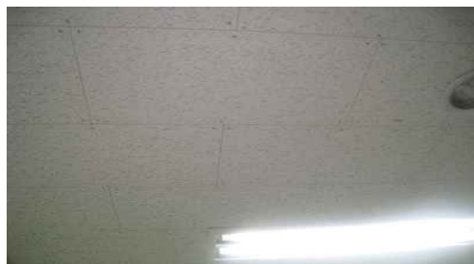
1. 칸막이 구획실 화재감지기 미설치
