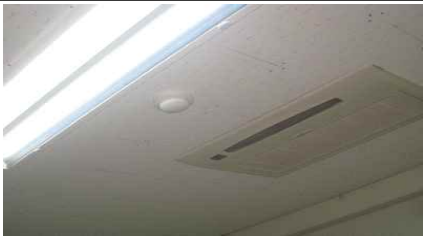
감지기 설치 부적합 (1)
