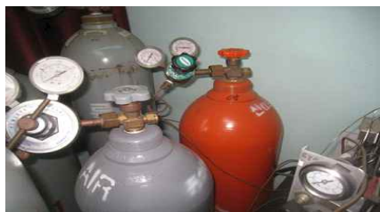
6. 가연성가스 누출경보장치 미설치 (수소)
