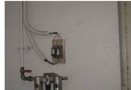
차단기 노출 설치
