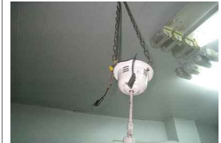
전선 절연 마감 상태 불량 (할로겐)
