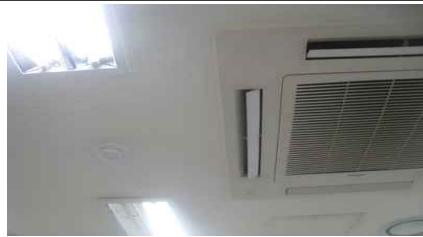
감지기 설치 부적합 (2)
