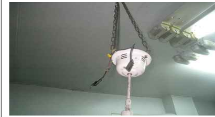
6. 전선 절연 마감 상태 불량 (할로젠)
