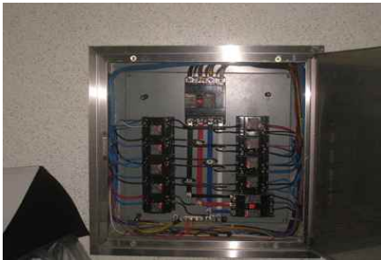
분전반 안전속판 탈락 상태
